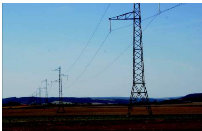
Ligne électrique à Blessonville
